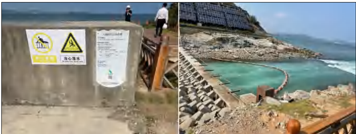
图 2.7-2 现有海水淡化系统排水和循环冷却水排放口设置情况
