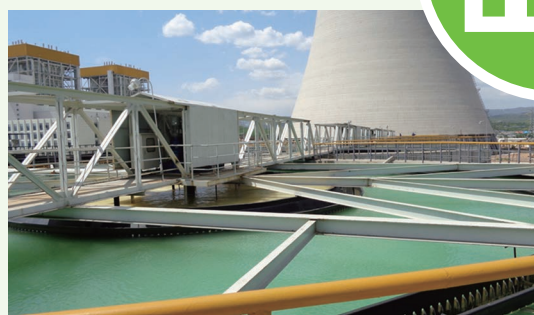
焦作电厂再生水重复利用
