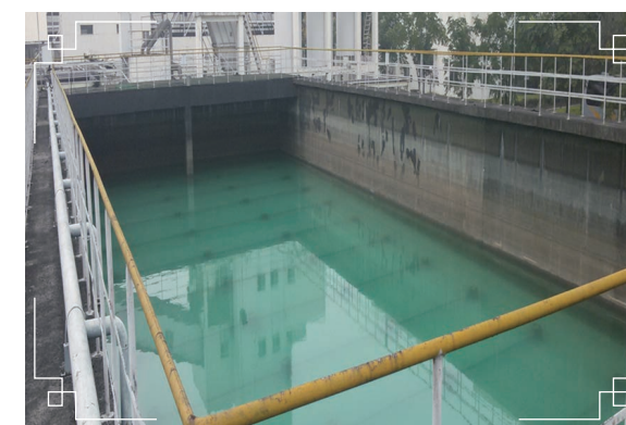
华润电力湖南有限公司工业废水处理站，经过处理的废水都可以循环利用，环保又节水
