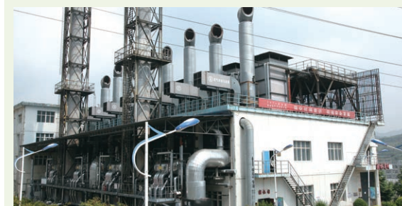
华润大宁参股建设的35MW瓦斯发电项目
