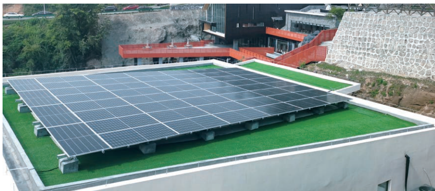
南江华润希望小镇公共建筑屋顶光伏
