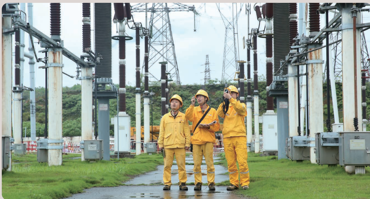
鲤鱼江电厂设备人员现场巡检
