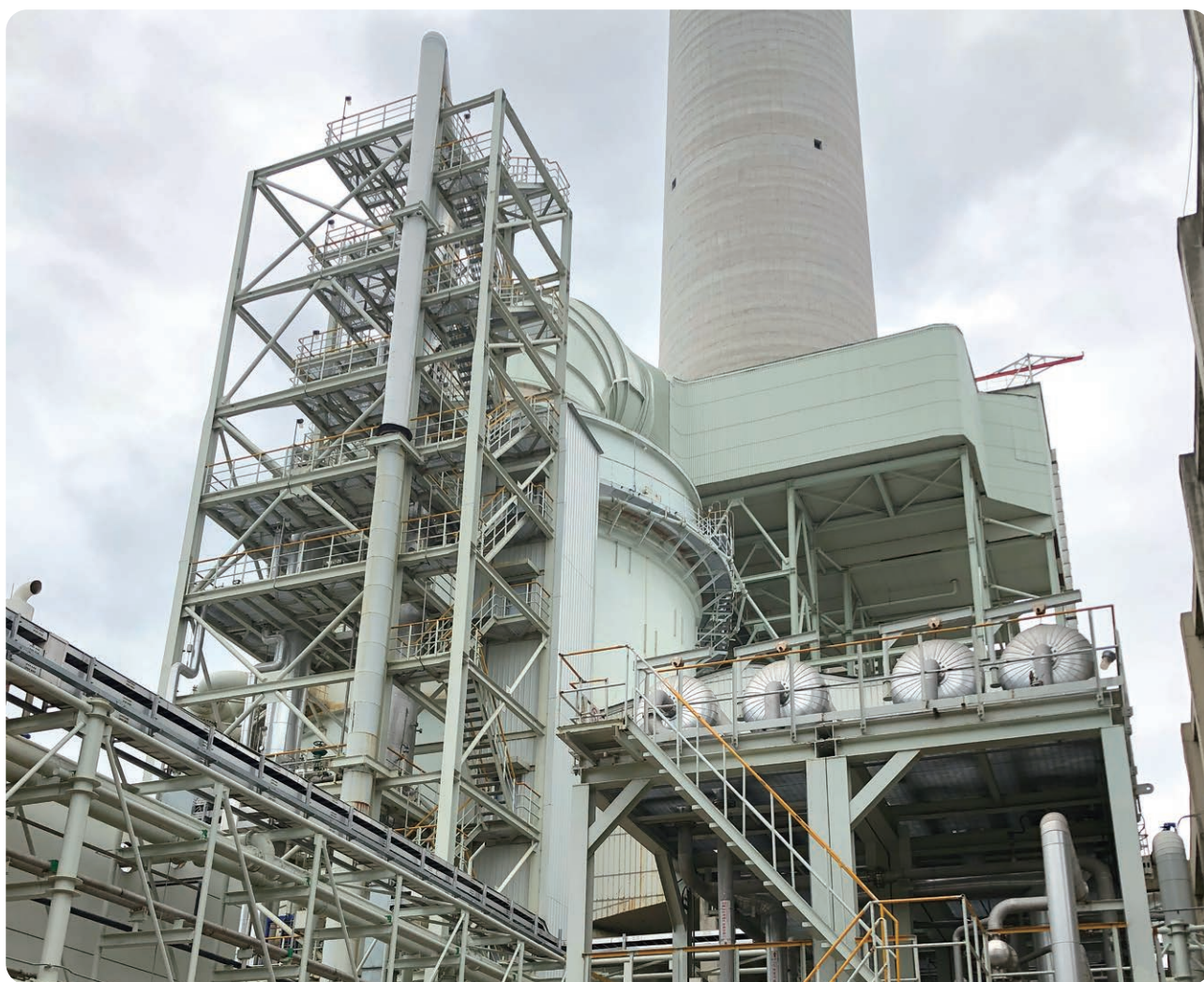
深圳公司碳捕集测试平台
